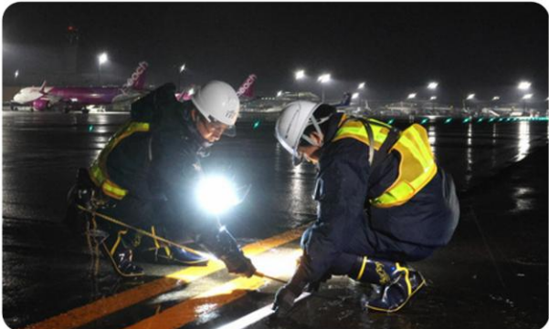
老朽化が進む空港施設の維持・修繕
