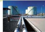
ヘッドラント方式の給油システムにより給油タンク車の燃料・排気ガスを削減
