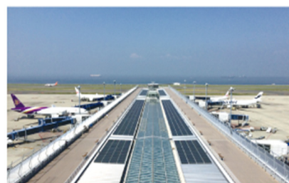
太陽光発電施設（第1旅客ターミナルビル）
