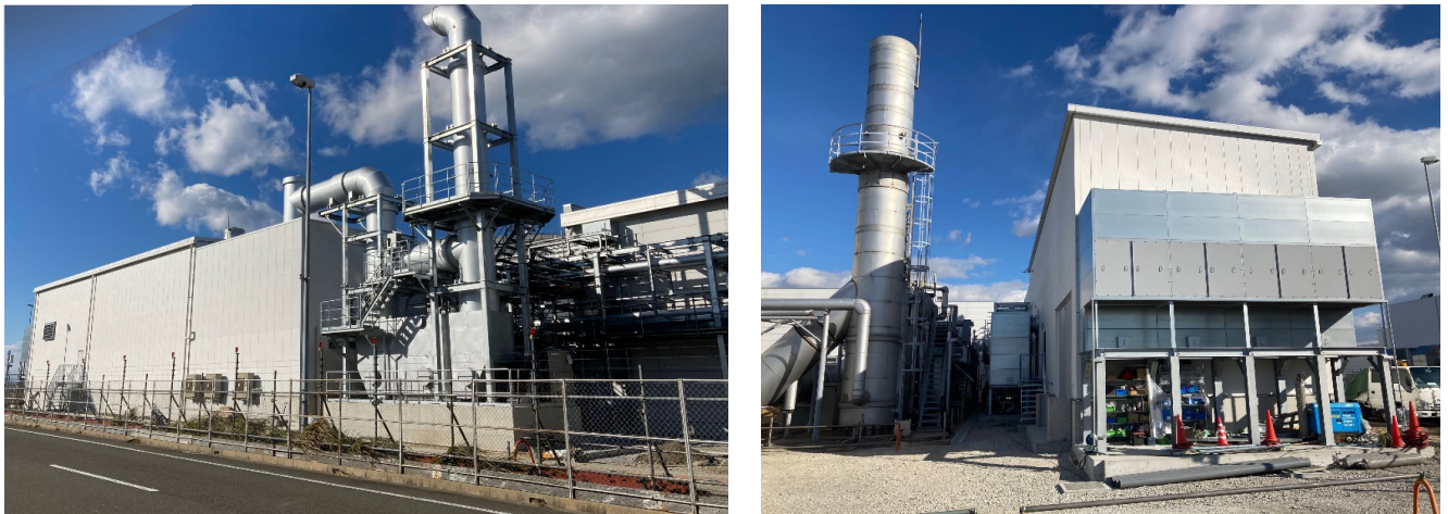
図 4.4-1 エネルギーセンター
