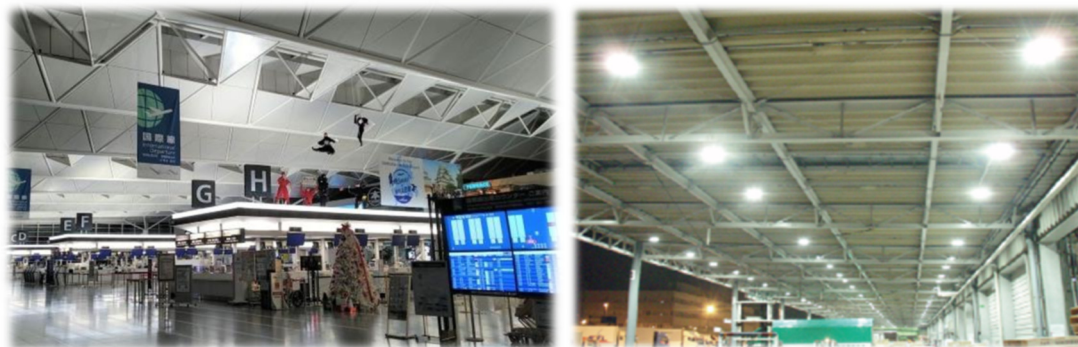
図 4.4-19 旅客ターミナルビル、貨物上屋の LED 化
