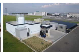
貨物地区水素充填所
