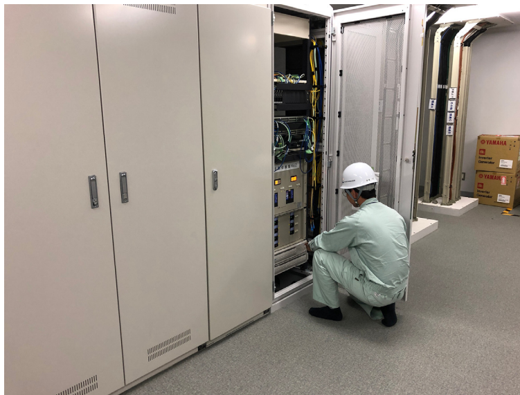
図 4.4-22 中部国際空港の UPS
