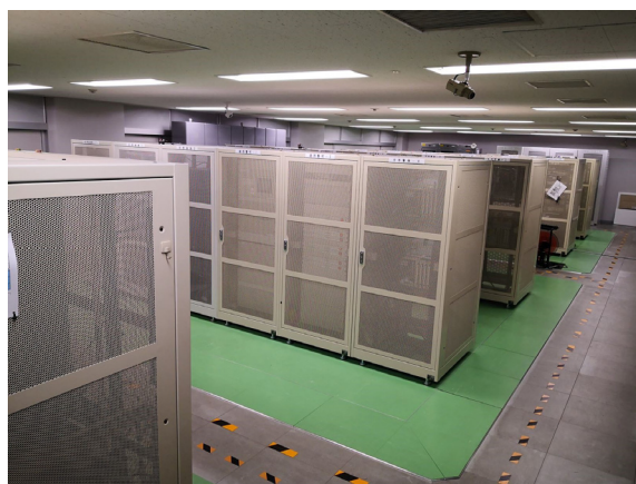
図 4.4-21 中部国際空港のサーバー
