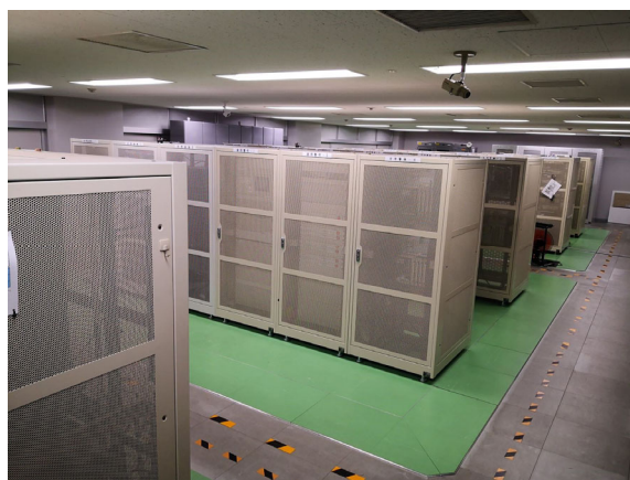
図 4.4-21 中部国際空港のサーバー
