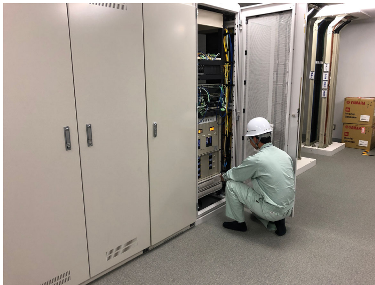
図 4.4-22 中部国際空港の UPS
