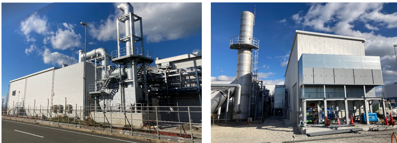
図 4.4-1 エネルギーセンター
