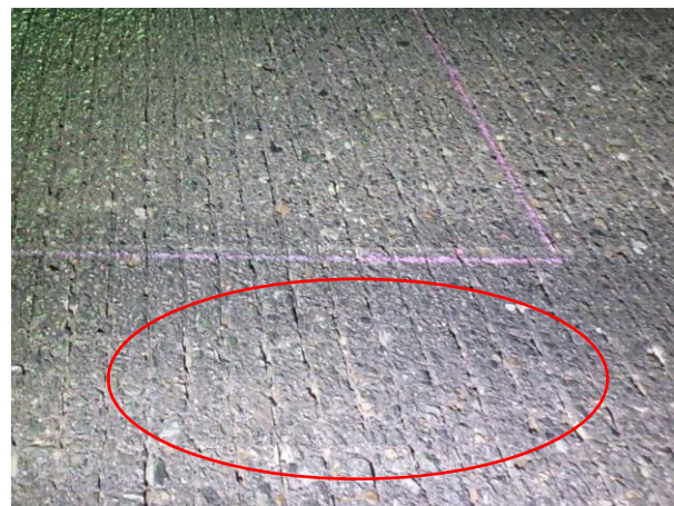
グルーピングの削れ・骨材の露出
