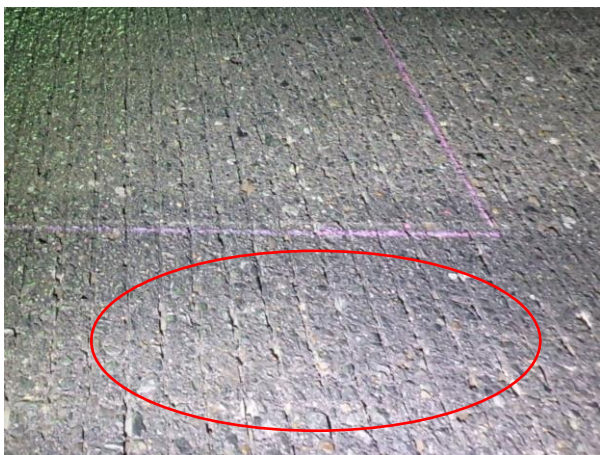
グルーピングの削れ・骨材の露出
